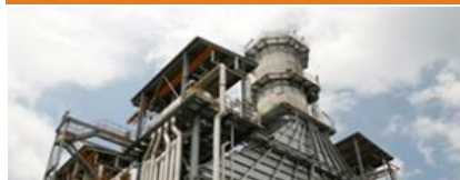
Keppel Merlimau Cogen
